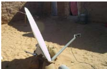
Conexión vía satélite
