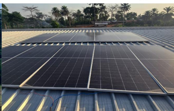
Figura A5.36. Instalación fotovoltaica del edificio central. Fuente: elaboración propia.
