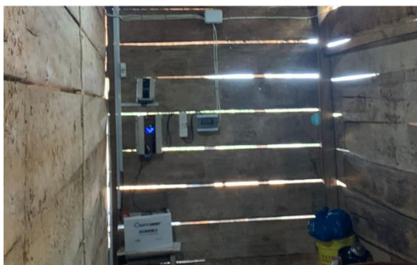
Figura A5.11. Componentes de la instalación fotovoltaica. Fuente: elaboración propia.
