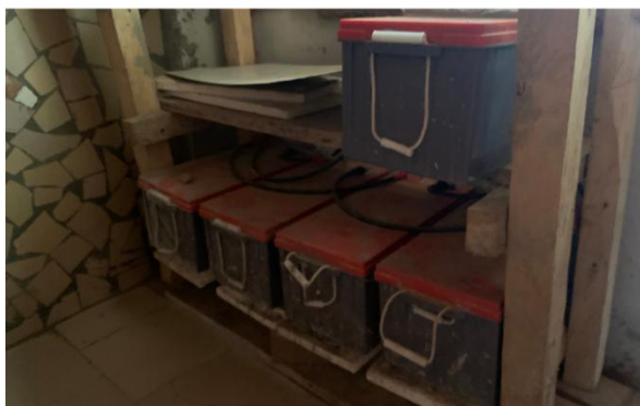
Figura A5.39. Banco de baterías del edificio central. Fuente: elaboración propia.
